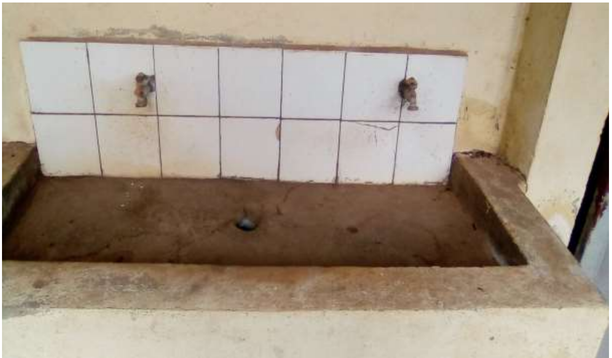
Image 4. Les robinets secs des installations sanitaires du campus Mutanga
