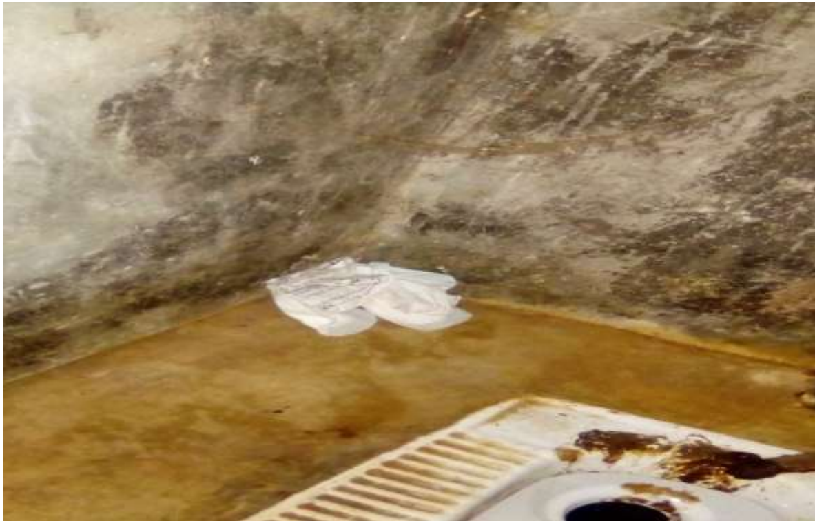
Image 2. Un tas des serviettes usées jetées au coin de la latrine.
