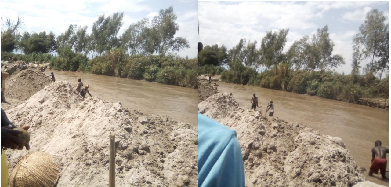
Figure II-3 : Photos prises sur terrain des travaux de curage sur la rivière Mutimbuzi
