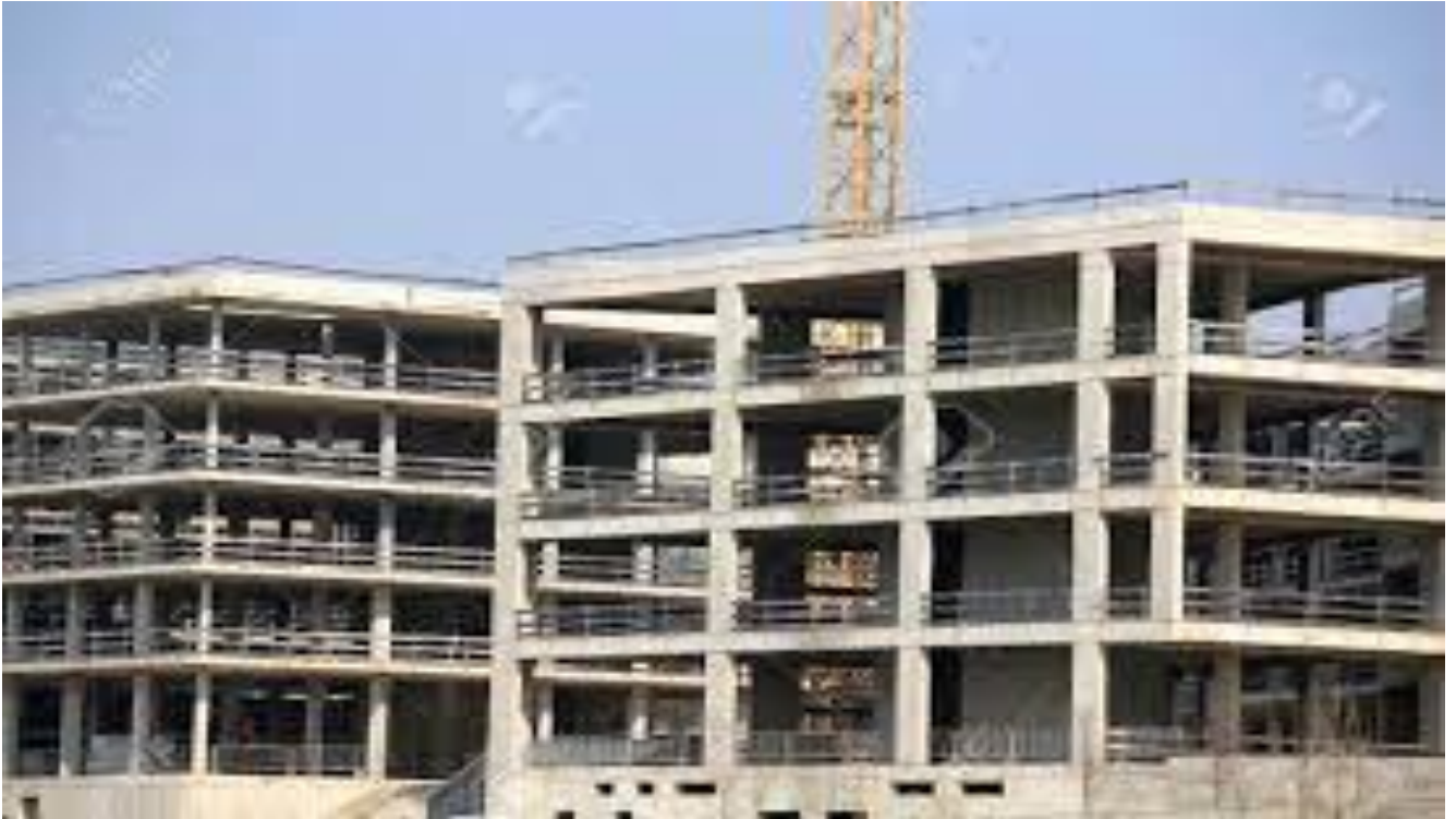
Figure III.16: Illustration des éléments porteurs d'une structure à risque de perte de résistance en cas d'incendie
