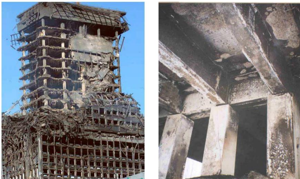
Figure I.3 : À gauche, photo du bâtiment Windsor à Madrid après l'incendie. À droite, dessous du tablier du pont à Bruxelles après l'incendie [3]
