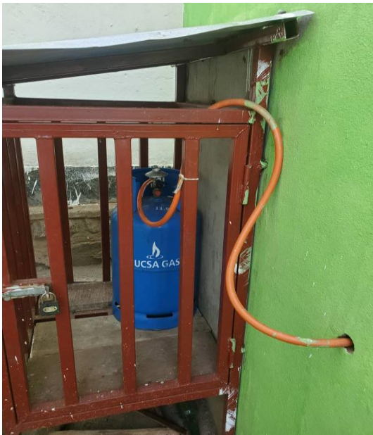
Photo 3 : Installation de la bouteille de gaz à l'extérieur de la maison
