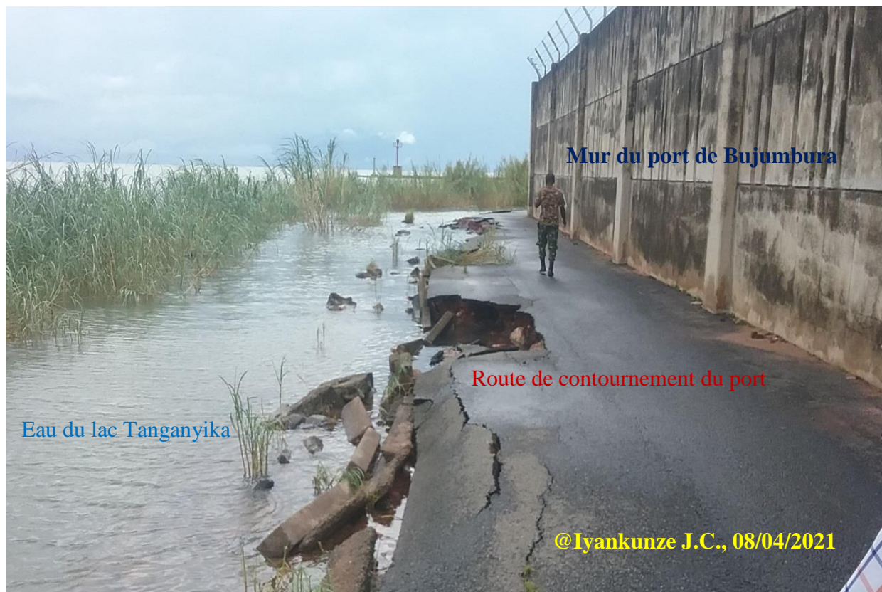
Photo 4.13. Erosion des berges menaçants plusieurs enjeux socio-économiques : route reliant le service de la marine, le bâtiment abritant le service d'immatriculation de l'OBR et les bâtiments portuaires de Bujumbura suite à la force de la marée haute
