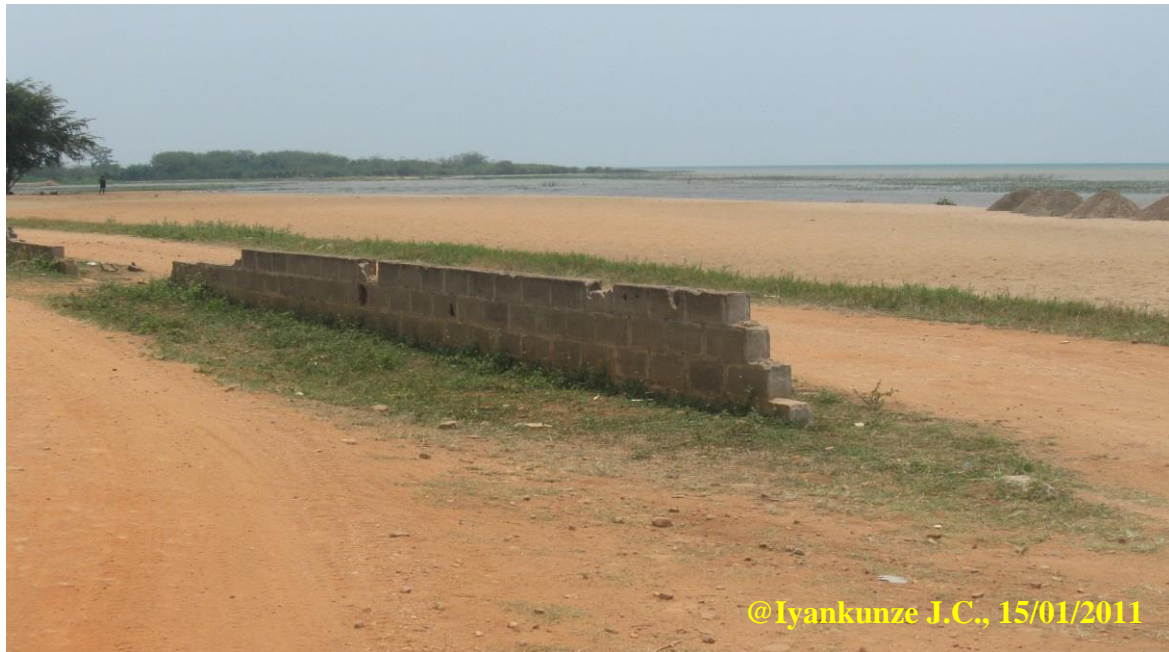
Photo 4.16. Mur préventif contre la transgression lacustre en destruction entre Kinindo bas et Kibenga « rural »
