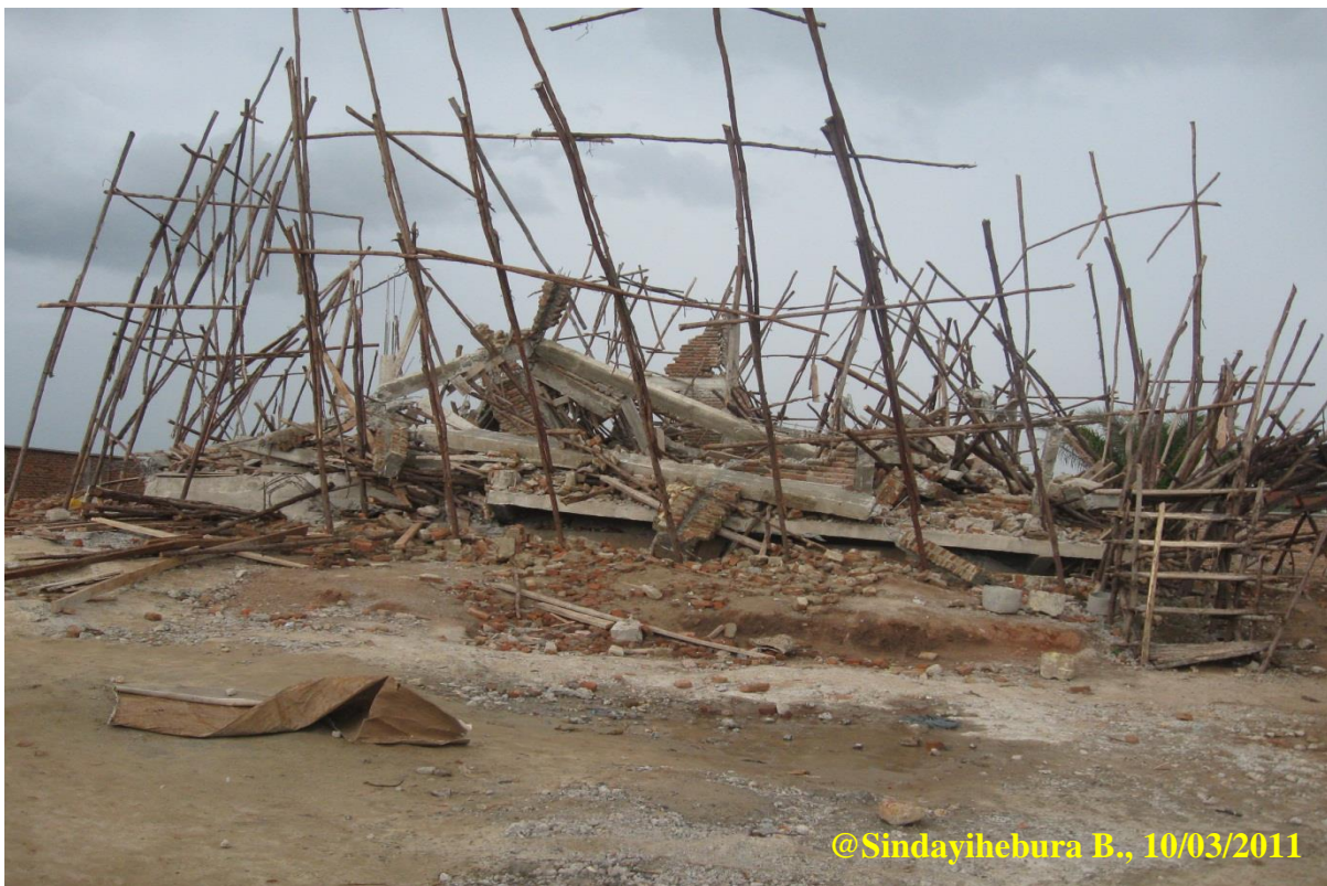
Photo 3.6. Maison effondrée le 9 mars 2011 à Kibenga « Rural »
