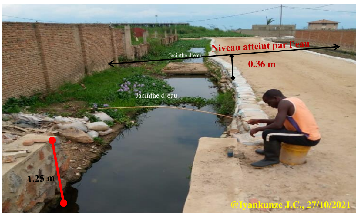
Photo 3.4. Niveau de la hauteur de submersion et caniveau devenu un lieu de pêche à Kinindo bas
