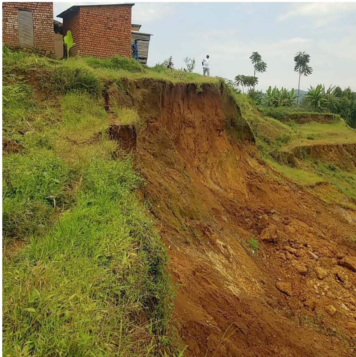
Photo illustrant les maisons menacées par les glissements de terrains
