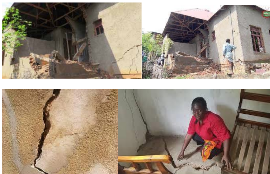
Photo 11: Fissuration du sol et destruction des maisons à Winterekwa (Source : ABP 26/03/2016)
