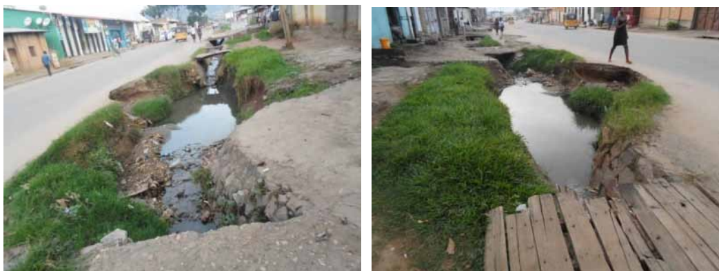
Photo 44 : Destruction de la route Gasenyi par les eaux pluviales (Source : Cliché Auteur, Photo prise le 15/12/2021)
