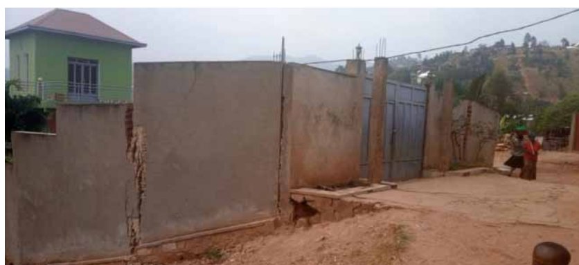
Photo 8 : Fissuration du sol et des maisons à Sororezo (Source : Cliché auteur ; photo prise le 21/08/2021)
