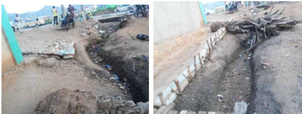
Photo 43: Erosion de la 8ème avenue à Mirango (Source : Cliché Auteur, Photo prise le 18/12/2021)
