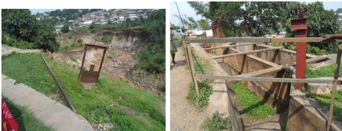
Photo 26 : Centre de captage et de traitement des eaux de la REGIDESO (Source : Cliché Auteur ; Photo prise le 08/01/2022)
