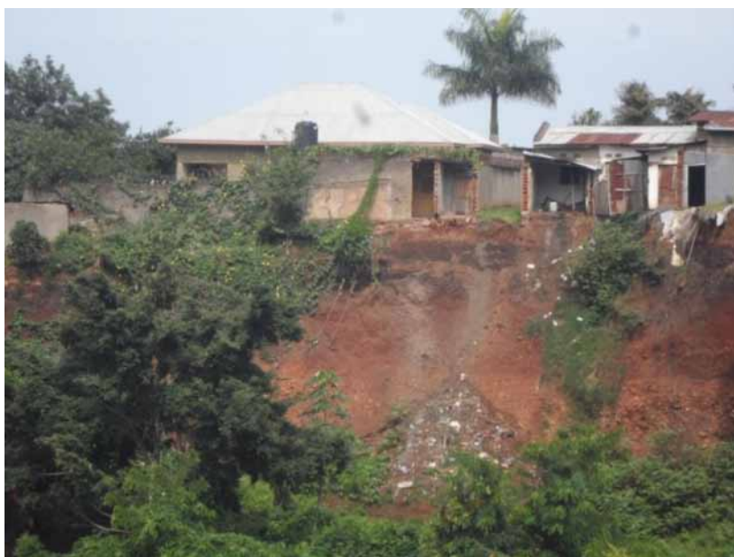
Photo 23 : Destruction des maisons par le ravin Nyenzari à Gihosha rural (Source : Cliché Auteur, Photo prise le 08/01/2022)
