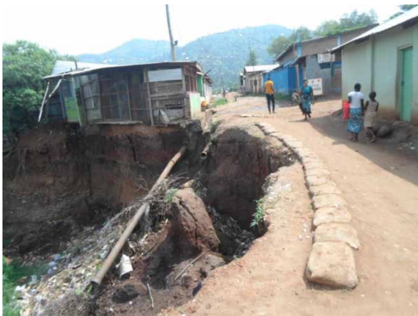
Photo 25: L'unique route de Mugoboka menacée d'écroulement (Source : Cliché Auteur ; Photo prise le 08/01/2022)
