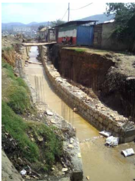
Photo 40 : Canalisation du torrent Cari au bord de la RN1 (Source : Cliché Auteur ; photo prise le 19/12/2021)
