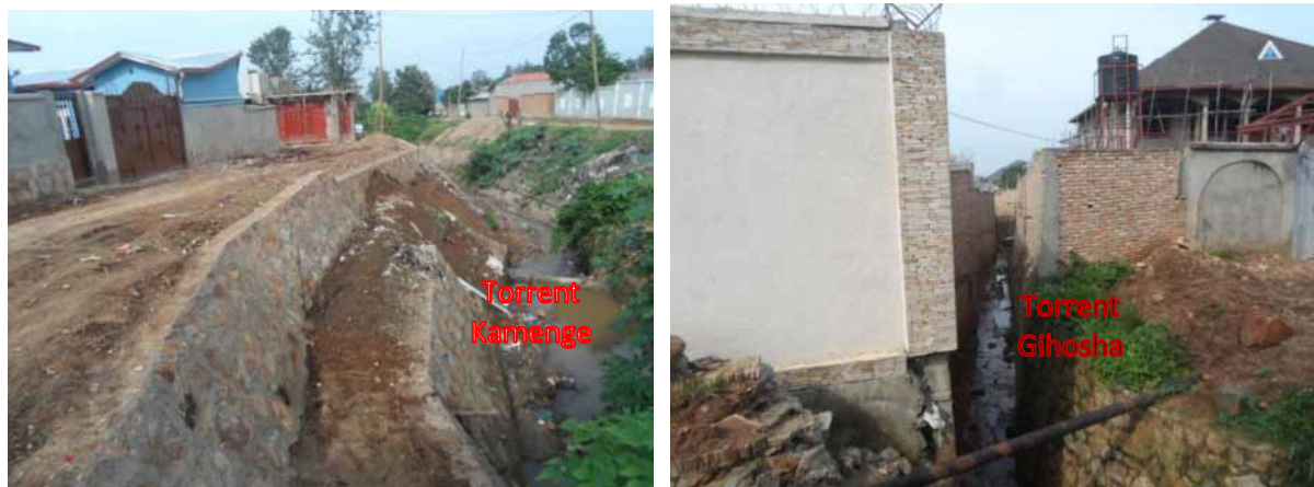
Photo 38 : Habitations érigés sur les lits mineurs des torrents agressifs (Source : Cliché Auteur, Photo prise le 08/01/2022)
