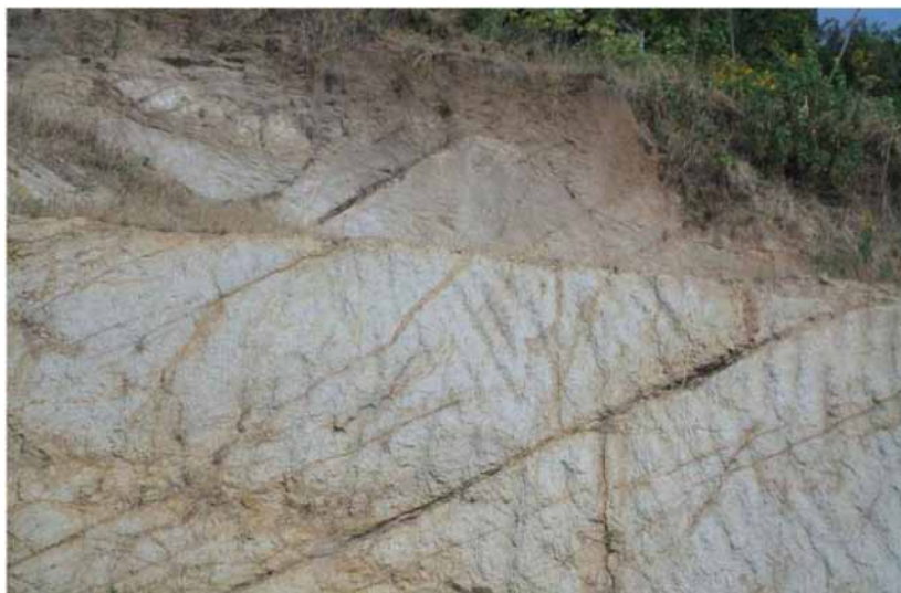
Photo 7 : Fracturation des roches gneissiques dans une fondation d'une maison à Kiriri
