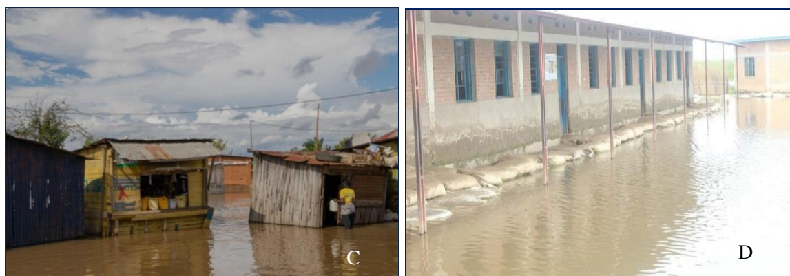
Figure 49: Faiblesse et ou absence des ouvrages de protection de l'école de Kinyinya II et des maisons à l'intérieur du Quartier, mars 2021 . Source: Iwacu, 2021
