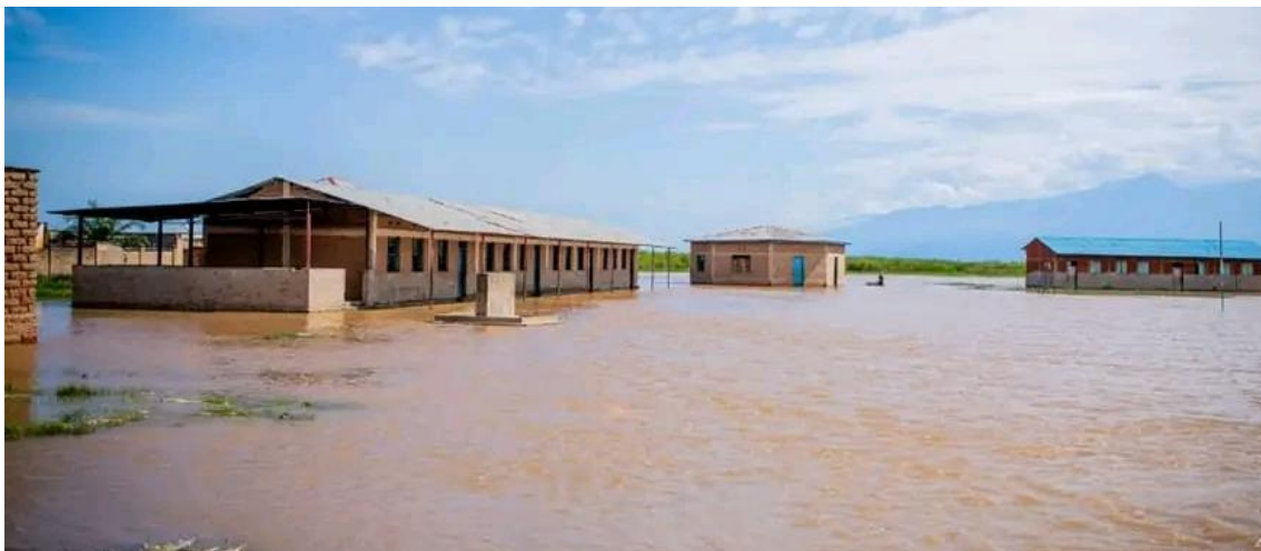
Figure 33: La cour de l'école primaire Kinyinya II submergée par des eaux provenant du lac Tanganyika, avril 2023.
