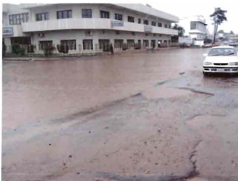
Photo 9: Dégradation de la voie d'accès après l'inondation (cliché SINDAYTHEBURA. B, 12 avril 2009)
