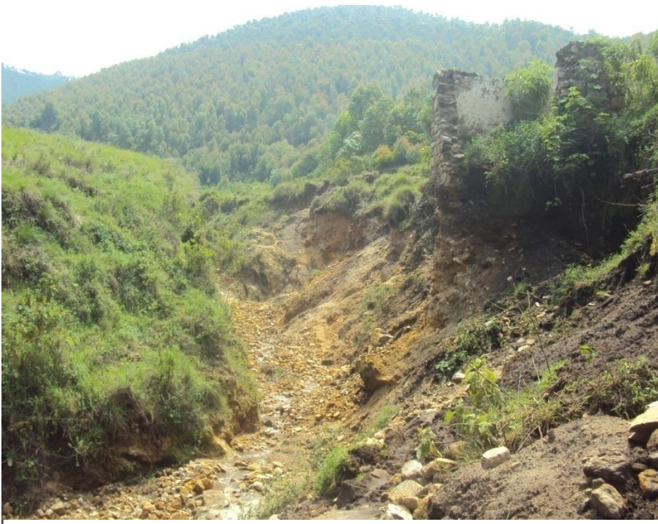
Photo 17: Installation hydraulique de Nyagonga ravagée par l'érosion.
