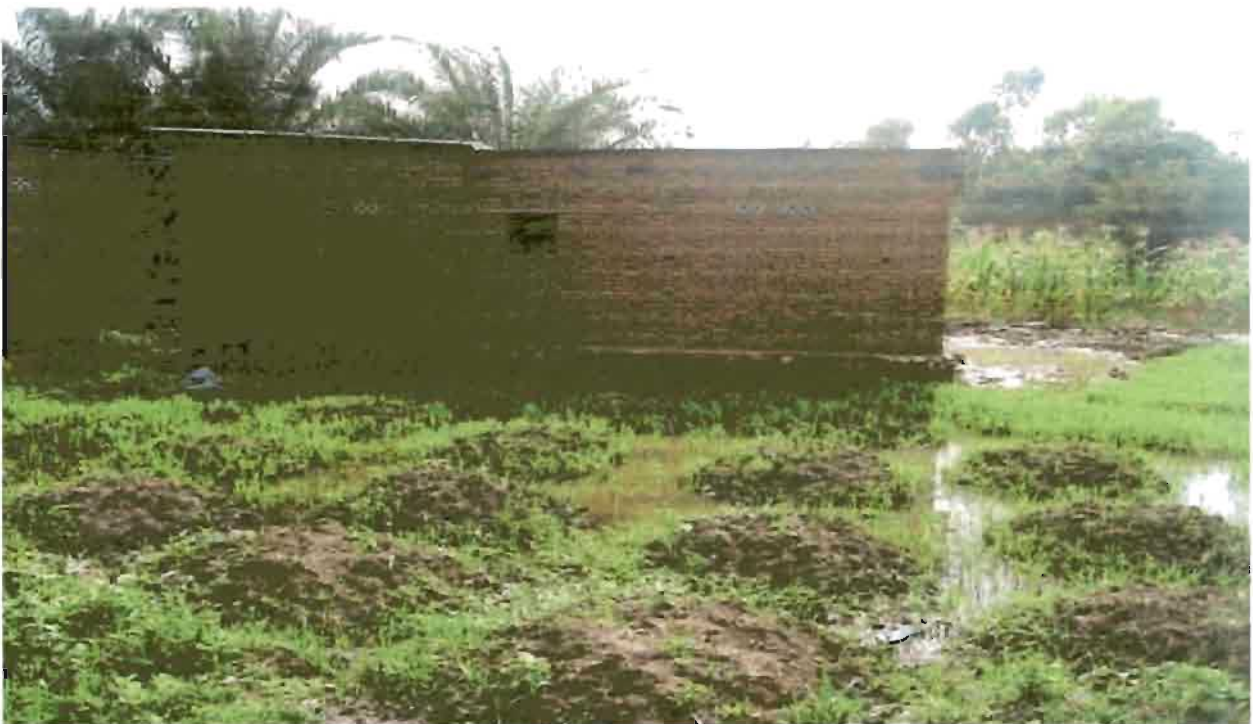
Photo 15: Une maison construite sur un terrain inapproprié à vertisol (cliché, auteur, 20 décembre2012)
