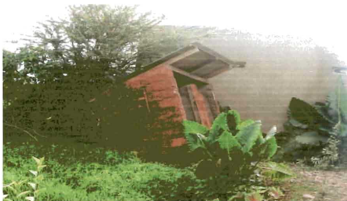
Photo 10: Une latrine effondrée et non fonctionnelle suite aux fortes pluies (cliché, auteur, 18 décembre 2012)
