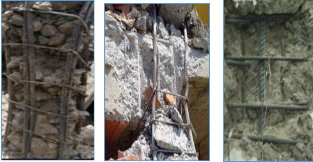
Figures 3.4 – Ruine des poteaux des immeubles en construction au Burundi.
