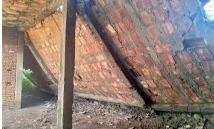
Figure 3.2 – Partie effondrée d’un immeuble au cours d’exécution au quartier Winterekwa , zone Kamenge, commune Ntahangwa.
