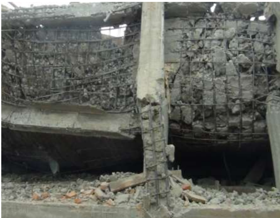
Figure 3.1 – Bâtiment effondré à Buterere, le 16 mai 2018, Quartier Miroir, source agence de protection civile.
