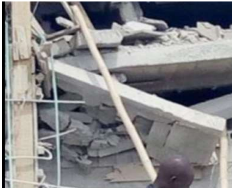
Figure 3.3 – Un immeuble effondré au cours d’exécution au quartier Kibenga.
