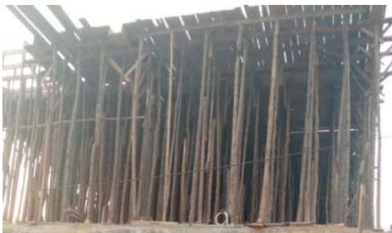
Figure 1.2 – Photo prise le 21 juin 2021 illustrant l'exemple de coffrage en bois des planchers en béton armé au Burundi.
