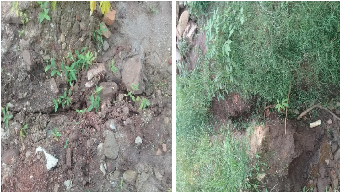
Photo1 : Les fissurations du sol de l'endroit
