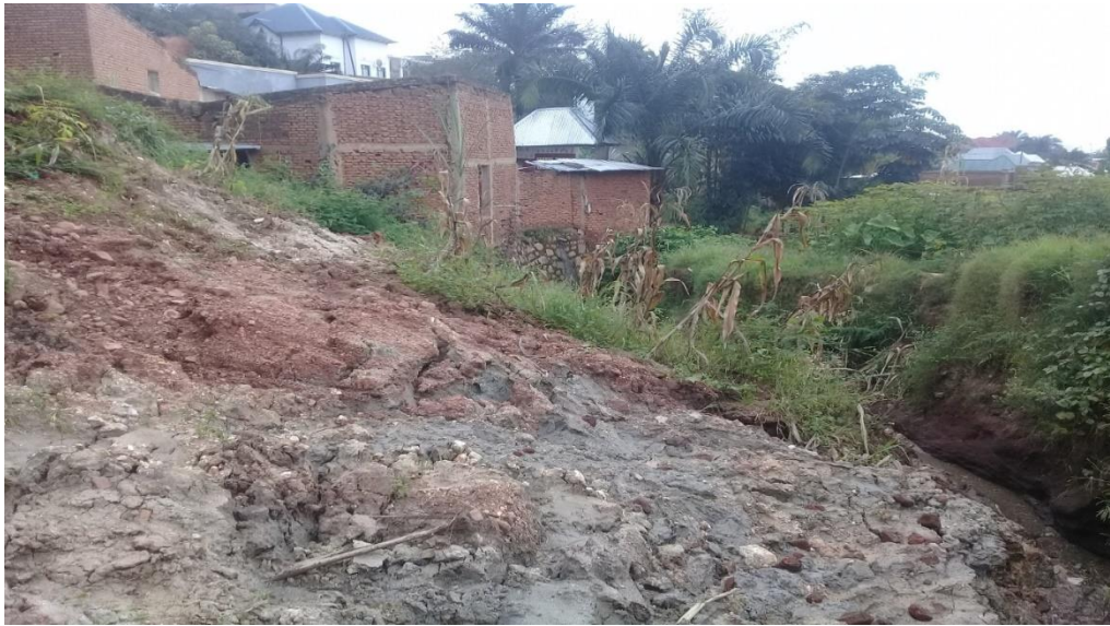
Photo 4 : Glissement en aval sous l'effet de la pression interstitielle.
