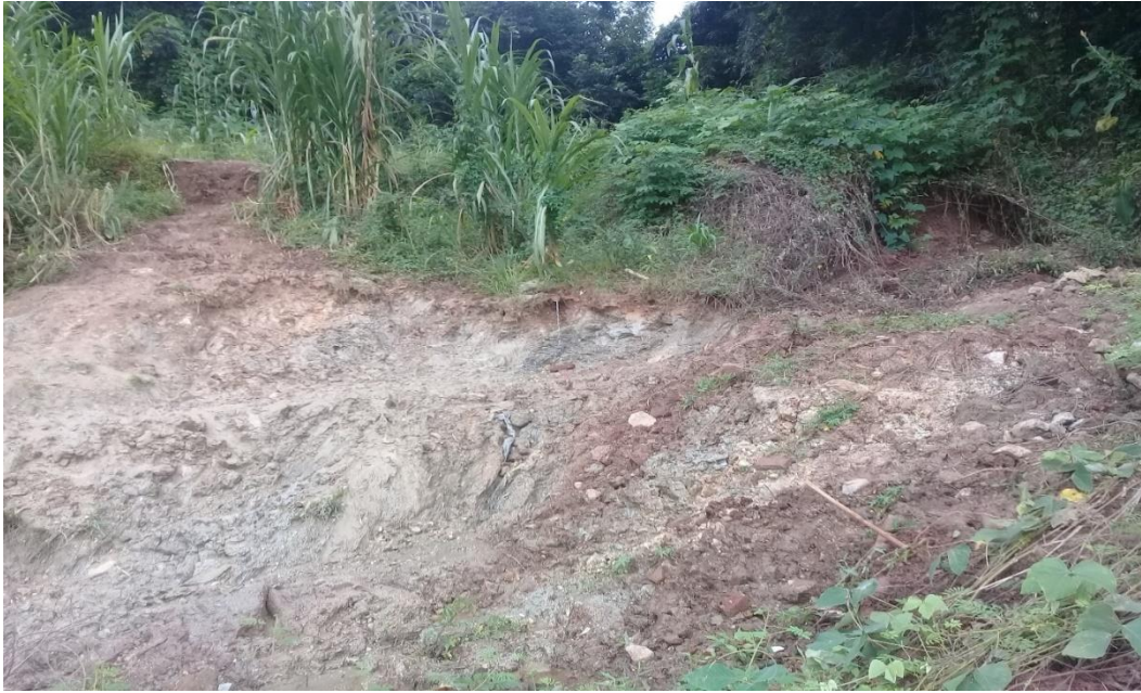
Photo 2 : L'amont où s'est créée une remontée d'eau capillaire.
