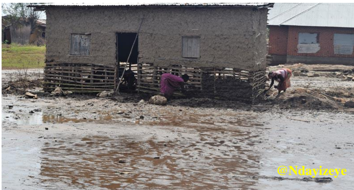
Photo 3.13 : Réparation d'une maison le lendemain des inondations à la 2 ème avenue, Kinyinya I à Gatumba
