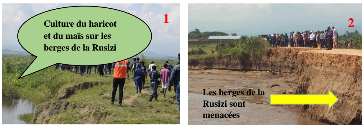
Photo 3.14 : Cultures sur les berges de la Rusizi et route sur la digue en cours d'écroulement
