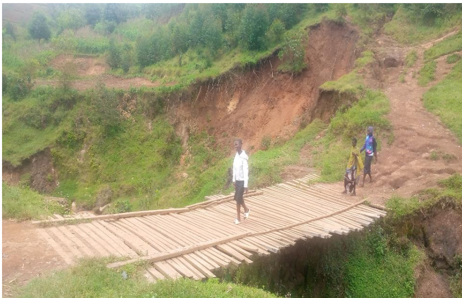
Photo 7: Destruction d'un pont reliant quartier Gatwaro et Kirwati par les eaux de ruissellement
