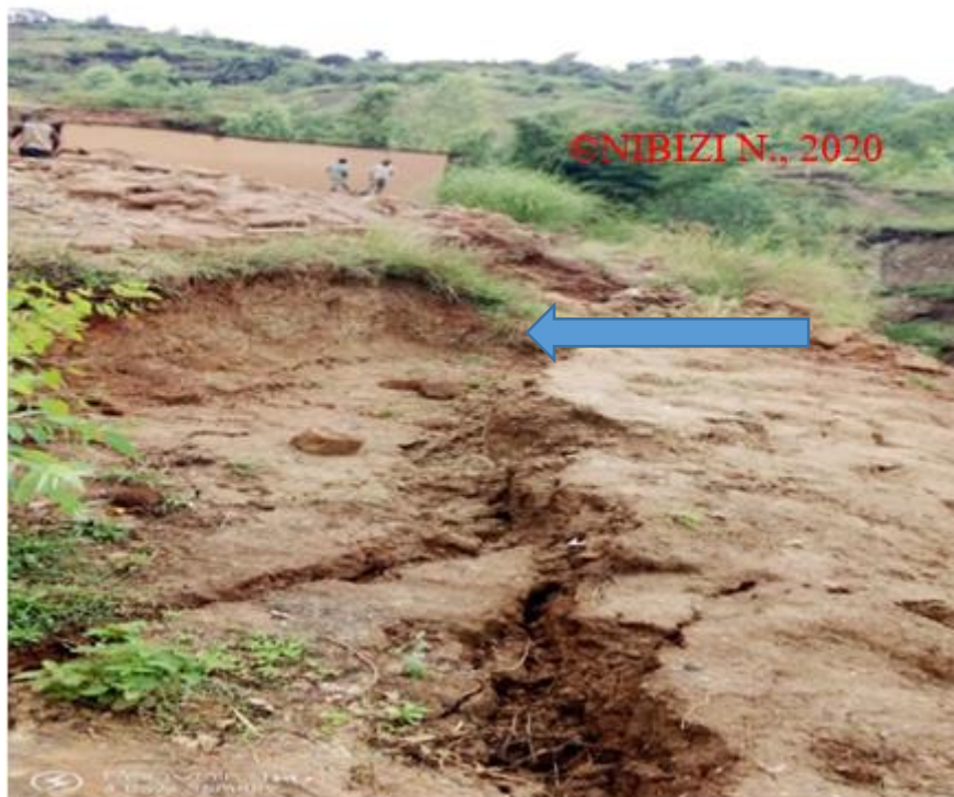
Figure 16: Glissement de terrain au quartier Busoro (Kanyosha). Photo Nibizi, le 25 avril 2020
