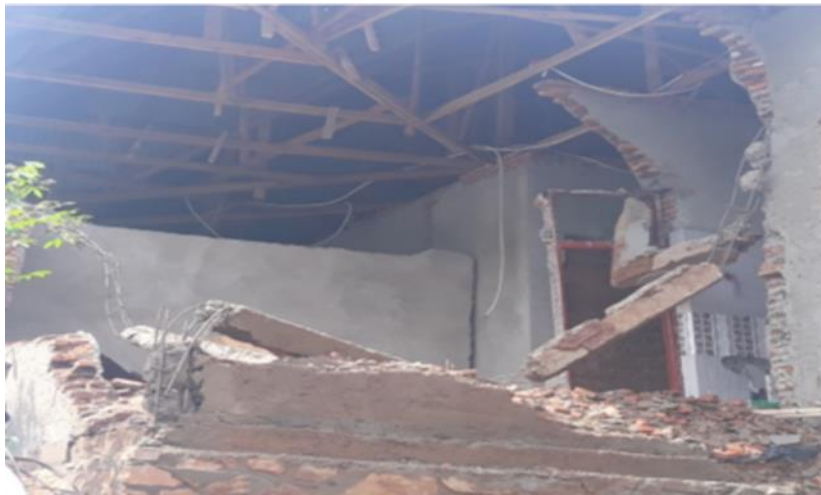
Figure 4: Conséquence du cisaillement du sol au quartier Uwinterekwa. Sabushimike, le 14 mai 2015
