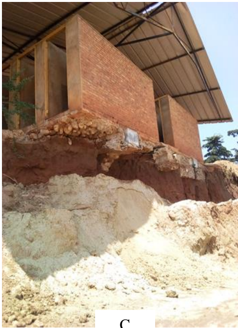
Figures (ABC) : Des maisons en danger d'érosion au quartier Kigobe. Photo Nibizi le 03 mars 2019
