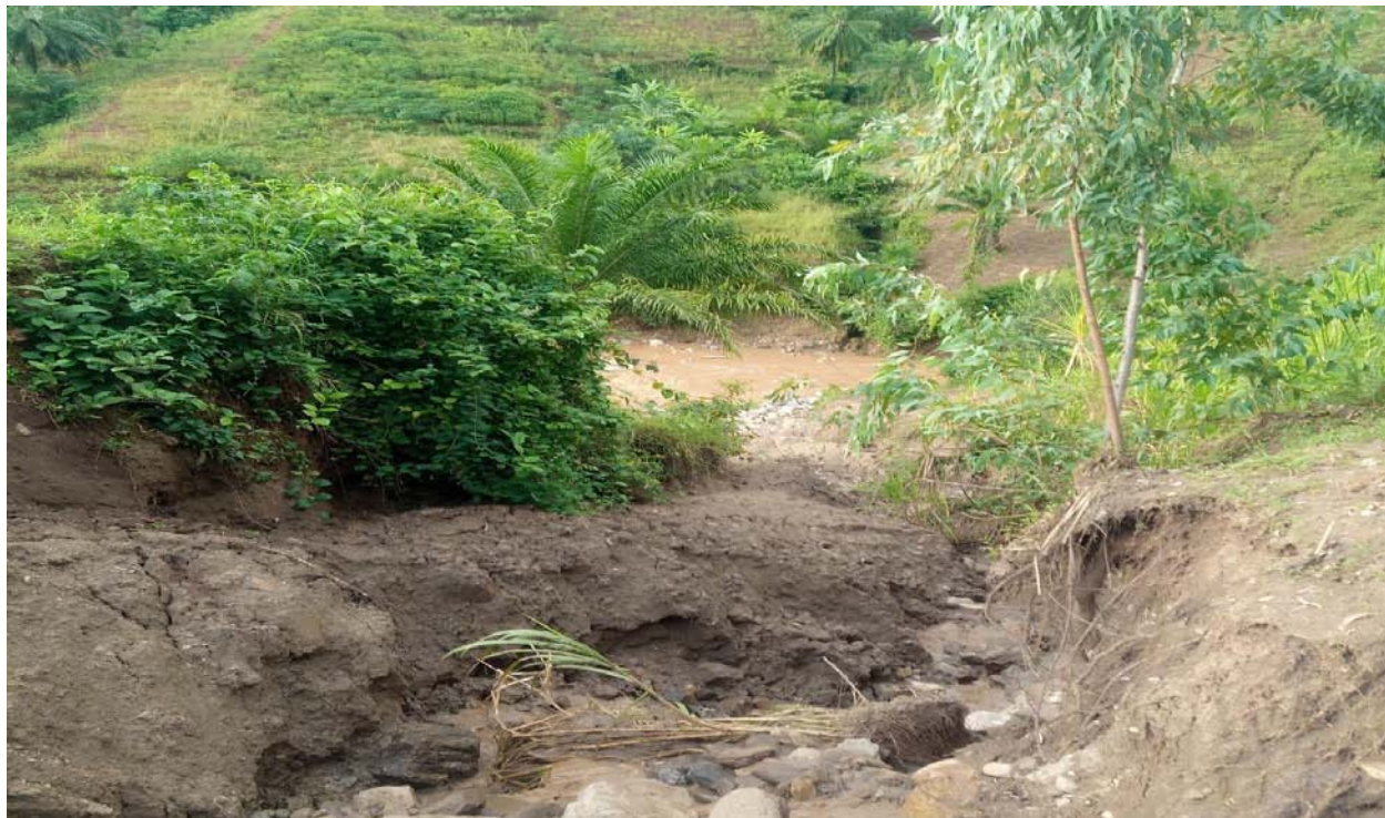
Figure 5: Ravins engendrés par l'érosion dans le BV du barrage
