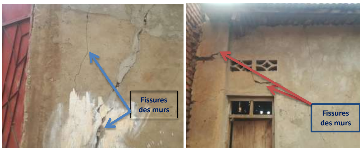
Photo 3 et 4: Murs des maisons fissurés et empoussiérés tout le long de la route en terre Source : Clichés de l'auteur. Photos du 03/12/2021
