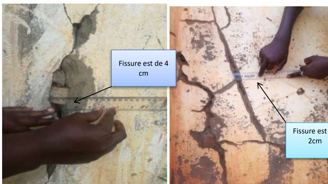
Photos 8 et 9: Murs des maisons en grandes fissures Source : Clichés de l'auteur. Photos prises le 03/12/2021
