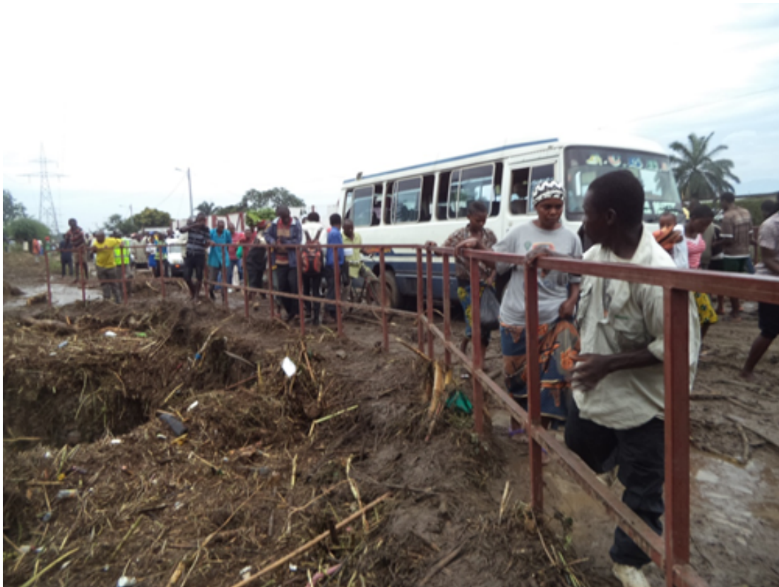
Photo 4 : Pont de la rivière Nyabagere bouché (Cliche Richard, le 10 février 2014)
