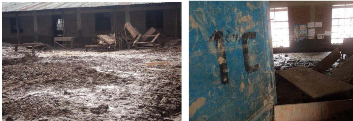
Photo III.5 : Destruction des infrastructures scolaires (écoles Gasenyi III (à Gauche) et Kamenge II (PNPRGC, 2014)
