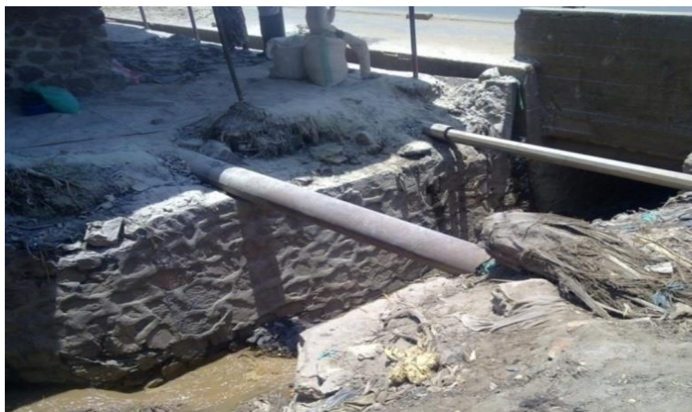
Photo III.8 : Destruction de réseau de distribution d'eau à Kamenge (PNPRGC, 2014)
