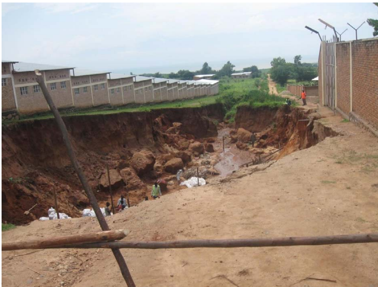
Photo III.3 : Lycée la Convivialité de Kanyosha menacé d’effondrement (SINDAYIHEBURA, 2011)
