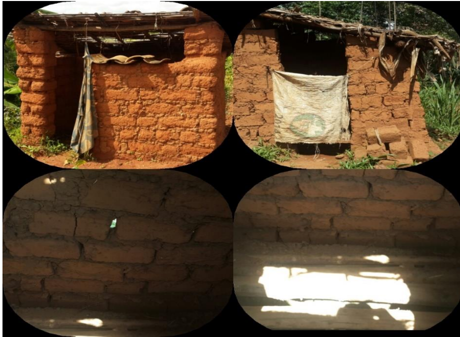
Photo 7 : Type de latrines extérieures le plus rencontré dans la région. Il s'agit plutôt de constructions de fortune de secours et non de véritables latrines. Et elles ne sont pas recouverte du tout ce qui expose la population aux maladies liées au péril fécal et à l'hygiène précaire.
