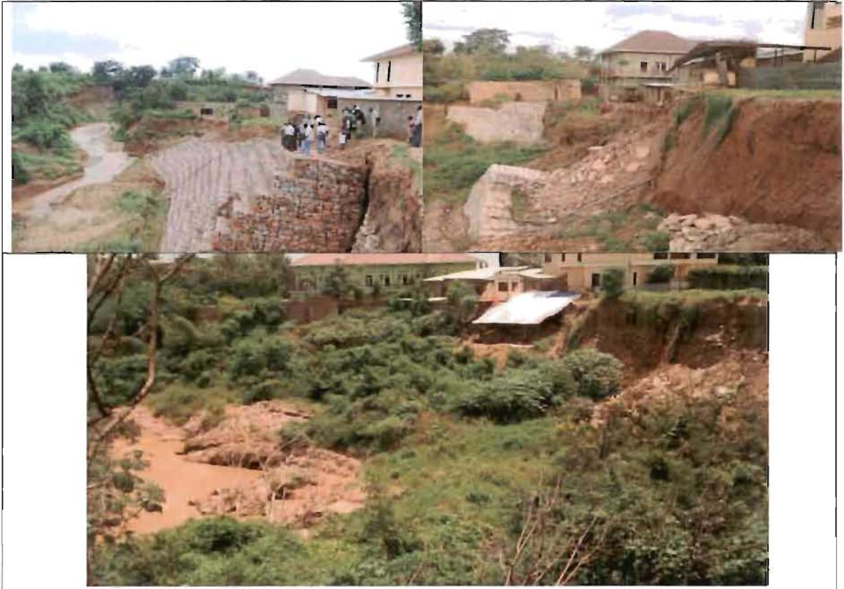
Figure 42, 43' et 43'' : illustration un mur de soutènement érigé il y a environ dix ans mais emporté par la rivière Ntakangwa avec comme cause principale : l'affouillement de pied du mur en question.
