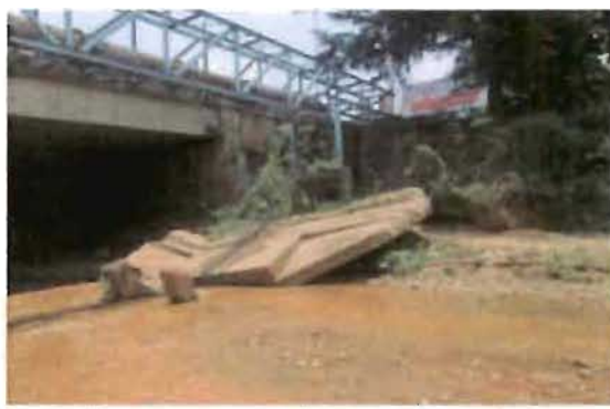
Figure 5 : renversement d'un mur de soutènement en aval du pont de la chaussée Peuple MURUNDI
