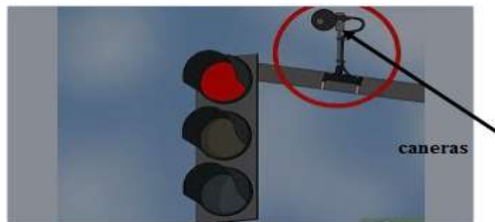
Figure II.4-camera de détection reliée par feu de circulation
