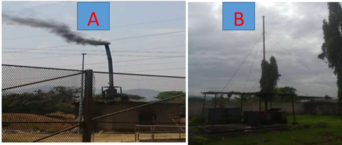
Figure 1: Photographie de l' incinérateur électrique à combustion pyrolytique du CHU Kamenge (A) et l' incinérateur de type montfort de la CPLR (B).
