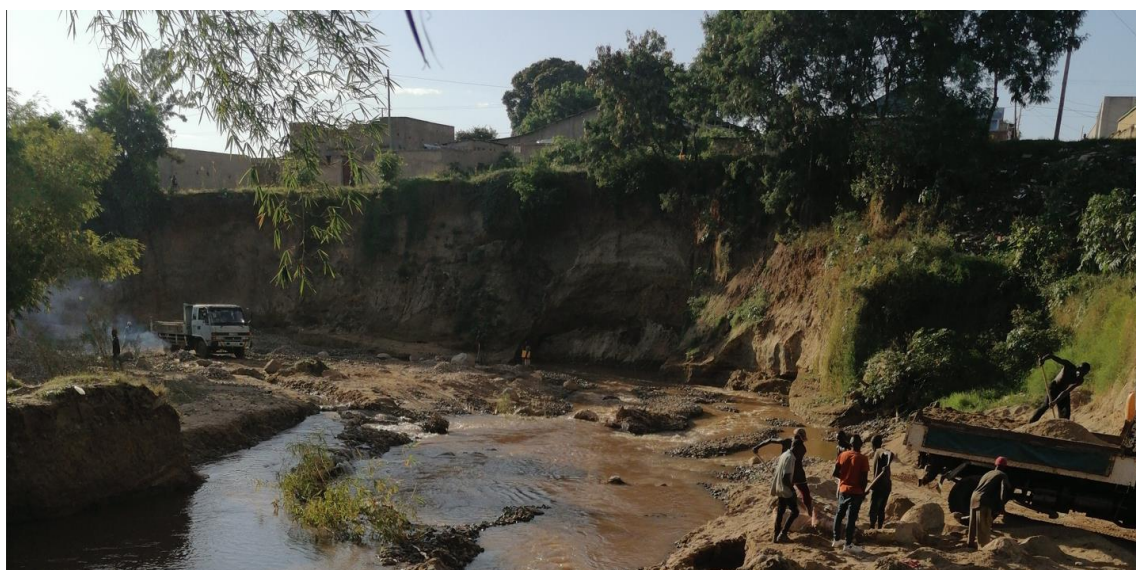
Figure II-4 : Glissement des berges sur une des sites d'extraction des granulats sur la rivière Kanyosha.
