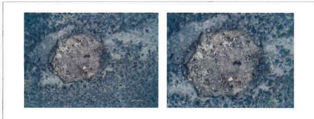
Exemple de nids de poule au milieu de la chaussée
