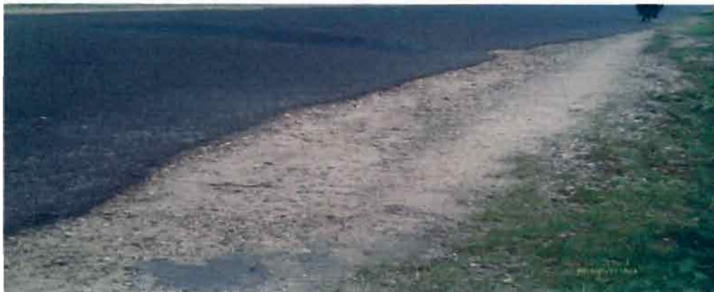
Exemple de la détérioration des accotements de la chaussée
