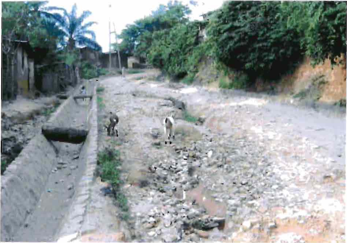
Fig. 13 : Une route défectueuse
