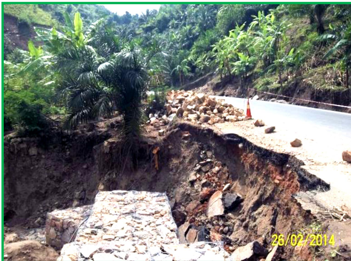
Photo 3.4 : Eboulement des talus de déblai ayant provoqué l'effondrement de la chaussée sur la RN1 (Muberure)
