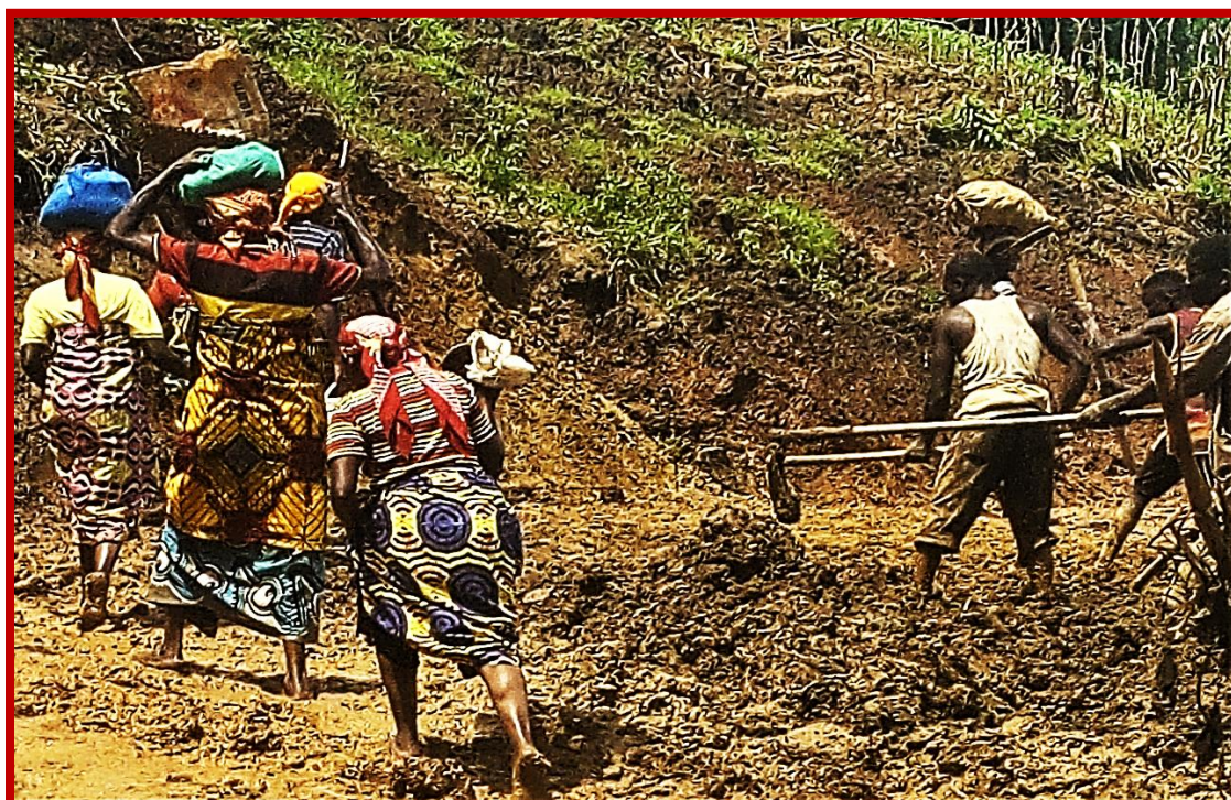
Photo 3.11 : Destruction de la route Rushubi- Kibuye, colline Nyarukere (cliché, auteur 12/5/2021)
