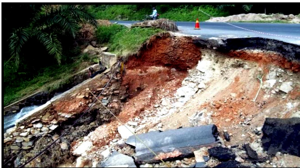
Photo 3.2 : Effondrement d'une partie du remblai et de l'accotement de la plateforme routière sur la RN1 à Muberure en 2014
