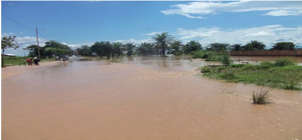
Photo 32: Hauteur de submersion à l'Est de la RN5 au niveau la piste reliant la RN5 et le chef-lieu de la zone Buterere
