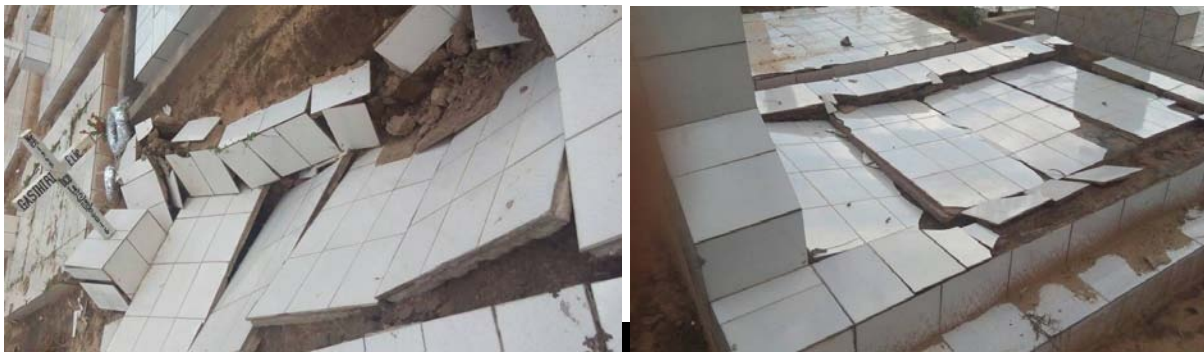
Photo 24 : Les tombes effondrées à Mpanda
