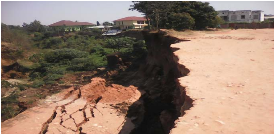
Photo 4 : Effondrement de la rive gauche sur la rivière Ntakangwa à Kigobe sur l'avenue Mukarakara.
