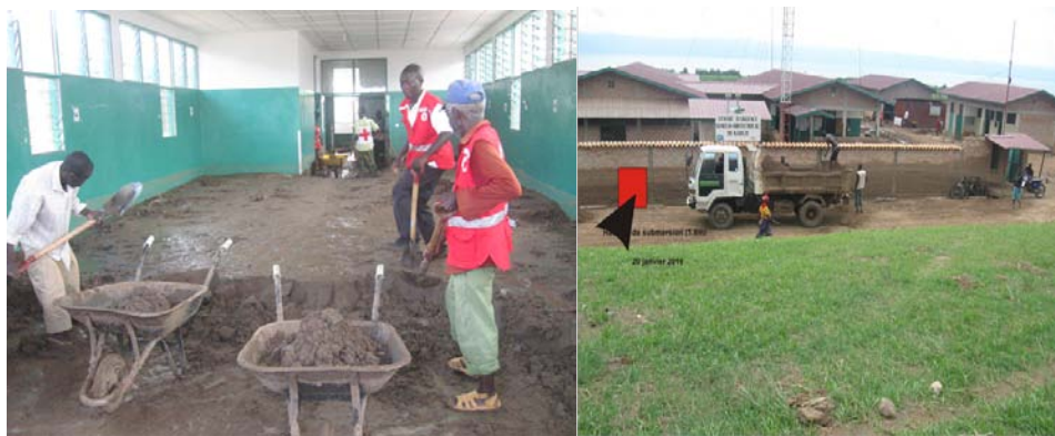
Photo 7 : Hauteur de la boue dans la salle d'hospitalisation et sur la clôture
