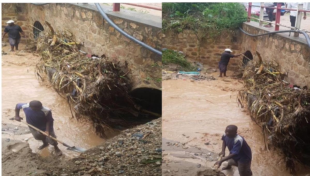
Photo 5: Photos pris le 28 /3/2023 illustrant le bouchage des ouvertures au point du pont de Av. Gasibe
