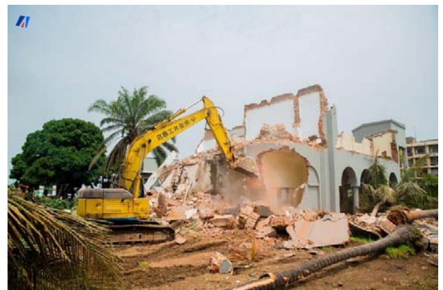
Déchets mixte de bétons et maçonnerie
