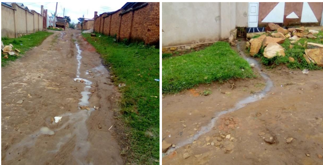
Photo 3.5: Eaux usées vagabondantes dans les rues dans le centre urbain de Matana (Quartier Busekuye)
