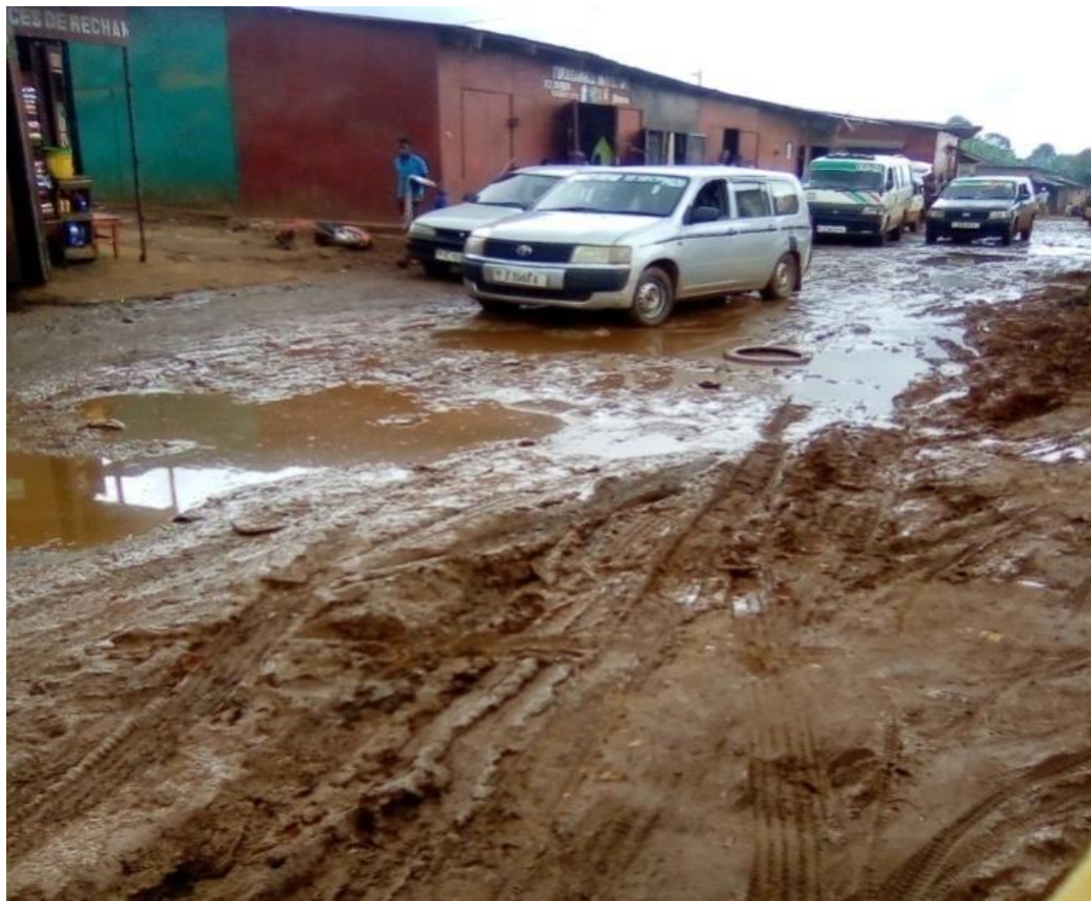
Photo 3.4: Problèmes de gestion des eaux pluviales aux alentours du marché de Matana après les pluies
