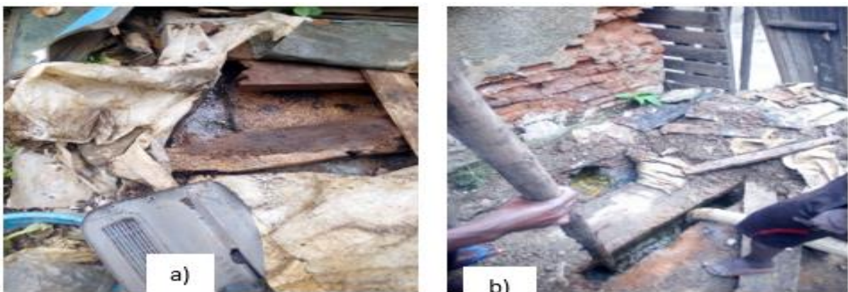
Figure 3.3 : (a) et (b) Fosse de stockage/ prétraitement mal entretenu en zone Buyenzi
