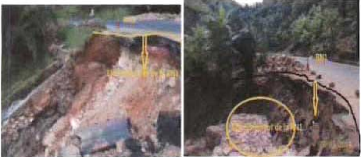
Figure 49: Effondrement de la RN1 à Muberureet à Benga
