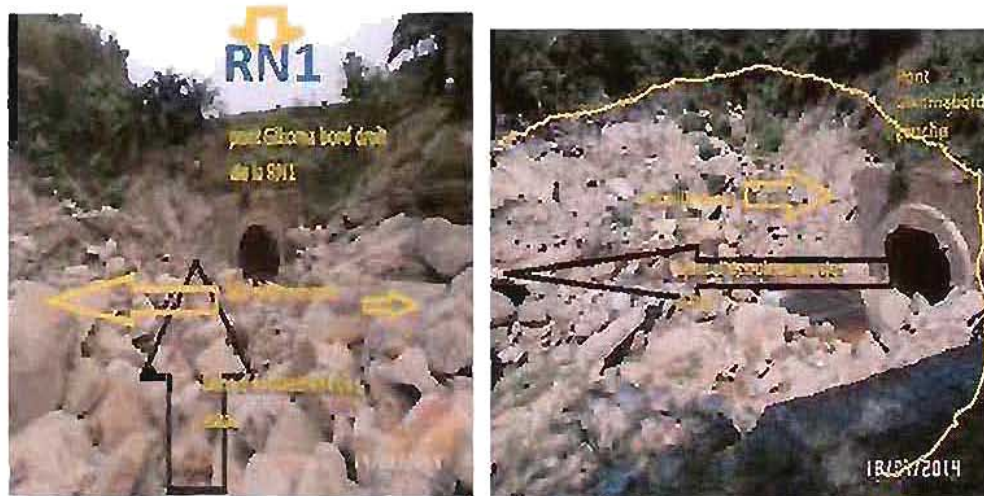
Figure 27: Affouillement sur le pont RN1: partie amont et partie aval
