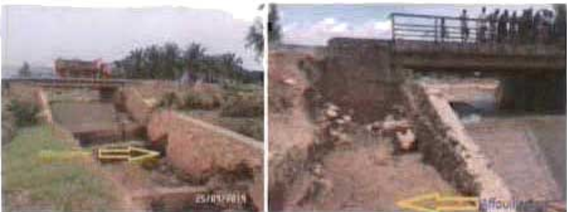
Figure 51: Affouillement sur pont de la RN9 au pk6
