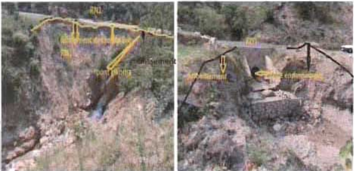
Figure 50: Glissement de terrain et affouillement sur RN1 à Mbirura
