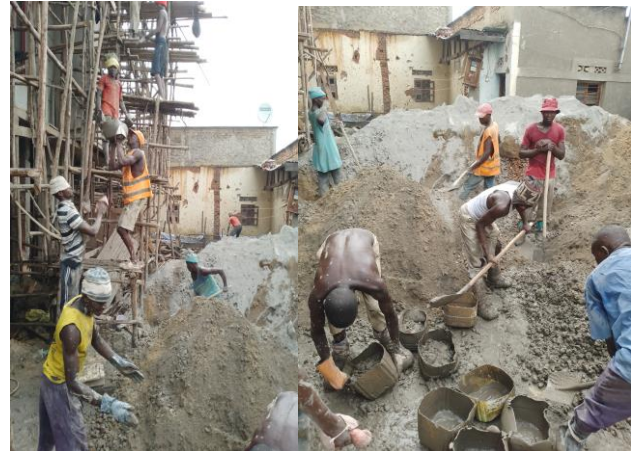
Activités de gâchage du béton à Kamenge, Rue n o 2, Kamenge Photo du 05/05/2025
