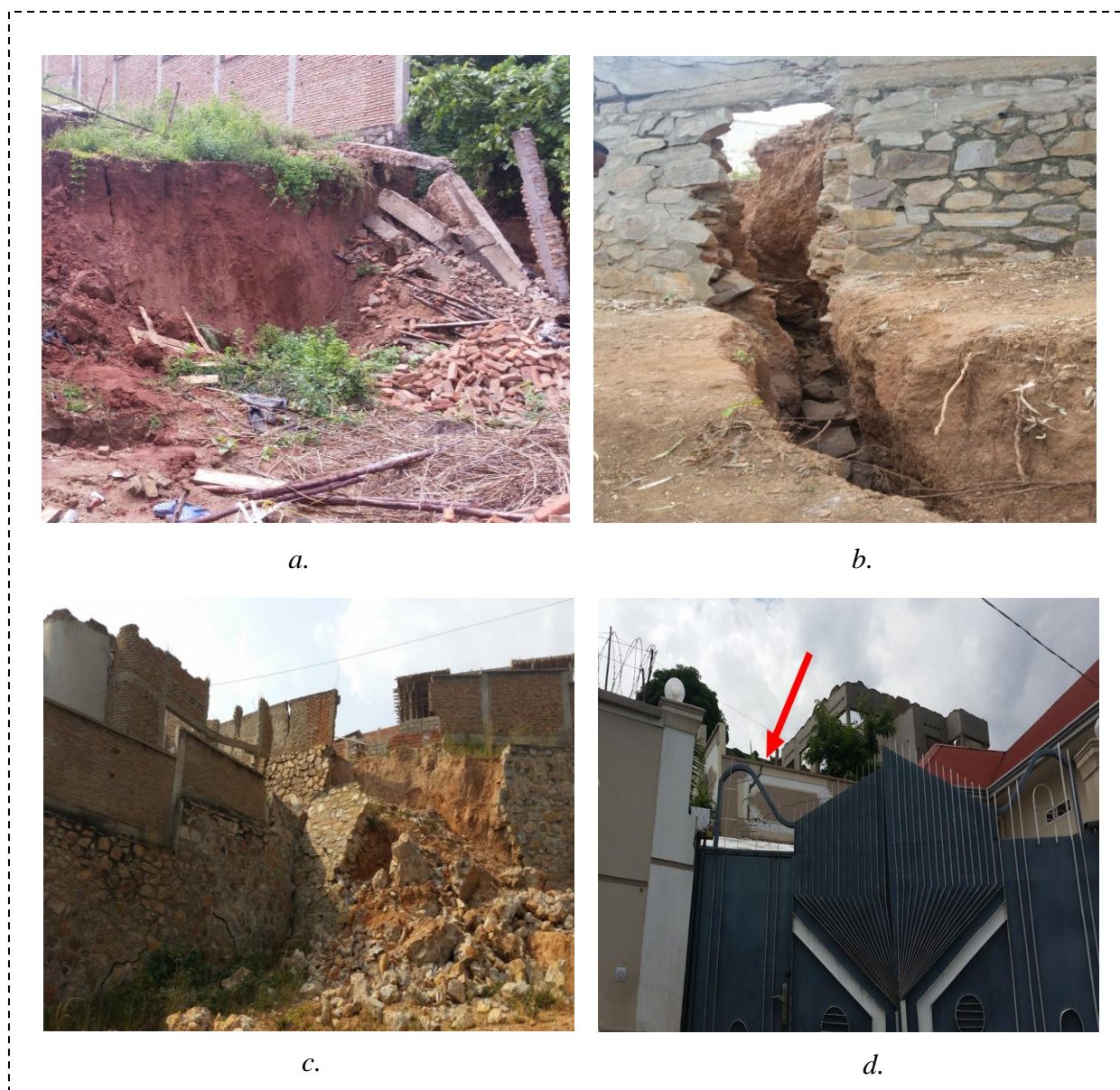
Figure 0-3 : Glissement des terrains & effondrement d'un bâtiment (a), fissuration du sol (b), destruction des bâtiments (c) et fissuration des bâtiments (d) au quartier Gasekebuye
