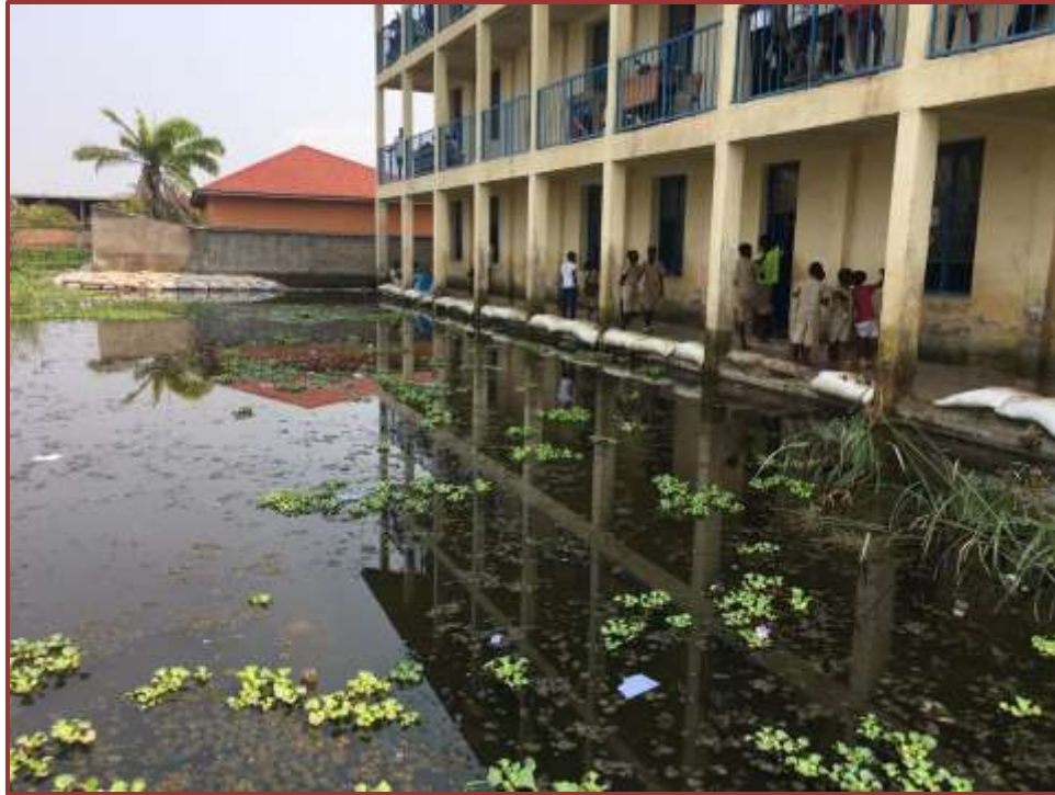
Fig.5. Structure présentant une forte attaque chimique dans le quartier Kajaga
