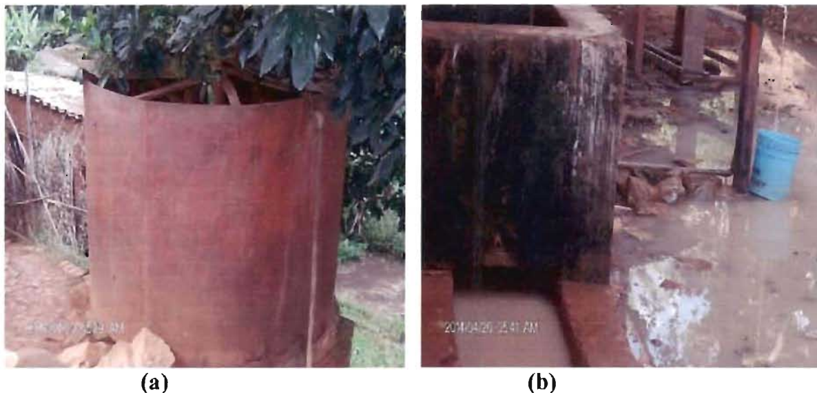
Figure 3: Photos illustrant la problématique de la gestion des eaux pluviales: (a) l'état du réservoir chargé de collecter les eaux pluviales au Lycée de Musema; (b) Inondation des eaux pluviales au lycée Musema (Cliché: Sabukunze, 2013)
