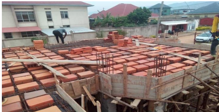
Figure 7: Photo illustrative des coffrages du plancher en hourdis prise sur chantier se trouvant à Nyabugete à Bujumbura Mairie par Edmond NIZIGIYIMANA
