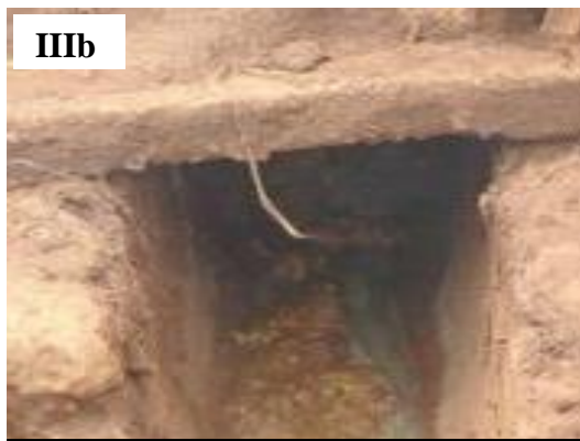
Rejet des boues dans les caniveaux
